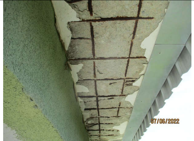
Foto nr. 2. Täielikult hävinenud betoonikiht ei kaitse armatuuri rooste ega amortiseerumise eest.
