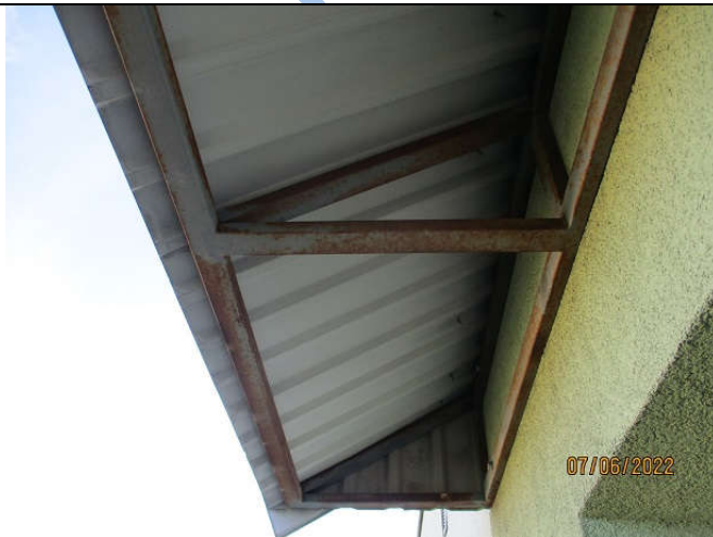
Foto nr. 5. Variaktuse kandekonstruksioon on roostes.
