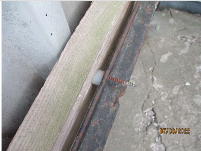
Fotod nr. 3-4. Kinnituselemendid ja -raam on korrodeerunud.
